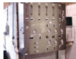
Panel badania wysokociśnieniowego zdolnego do wytworzenia ciśnienia 500 barg (7150 PSI) z łączem wideo do komórki testowej
