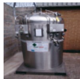
Zbiornik ciekłego azotu
